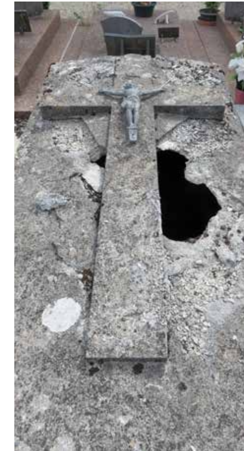
Tombeau en pierre reconstituée, cimetière de la ville basse, Provins (Seine-et-Marne). Une fabrication sans doute défectueuse en a accéléré le délitement.
